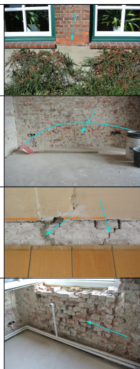
Bild 5 Nordost-Fassade (Anbau Raum II) Aufsteigende Feuchtigkeit ist durch den vorh. Sperrputz gehindert im unteren Bereich sich der Umgebungsfeuchtigkeit anzupassen. Erhöhte Wasserzunahme oberhalb des Putzes führt zu Frostsprengung im Mauerwerk.
