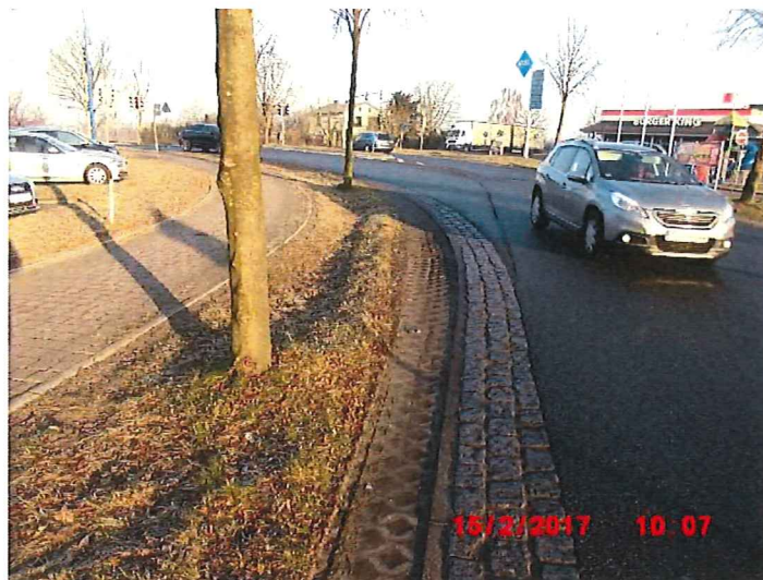
Bild 4: Lise-Meitner-Allee, südwestliche Zufahrt, Blick in Richtung Ahrenloher Straße, abgesackte Bankettbefestigung
