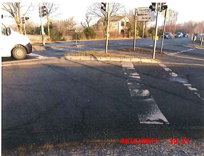
Bild 2: Einmündung Lise-Meitner-Allee, Blick in Richtung Ellerhoop, deutliche Lunken und Ausbrüche in der Asphaltfläche sowie schadhafte Fahrbahnmarkierung
