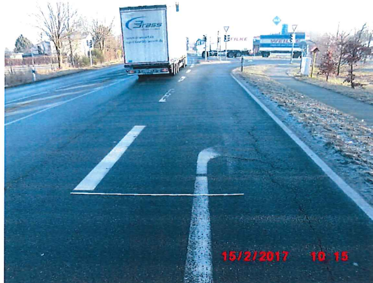
Bild 3: Ahrenloher Straße (L 110), südöstlicher Fahrbahnrand, Blick in Richtung Ellerhoop, Längsrisse in der Asphaltfahrbahn sowie schadhafte Fahrbahnmarkierung
