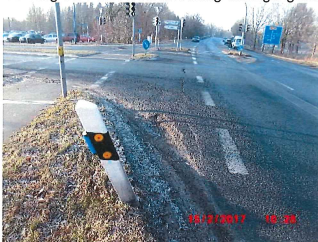
Bild 1: Ahrenloher Str. /Lise-Meitner-Allee, Blick in Richtung Autobahn, schadhafte Asphaltdeckschicht mit Längsrissen und Bankettschäden
