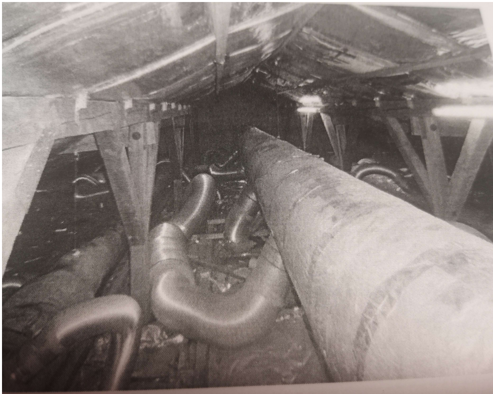
Abbildung 8: Foto Lüftungsanlage über dem Ratssaal
